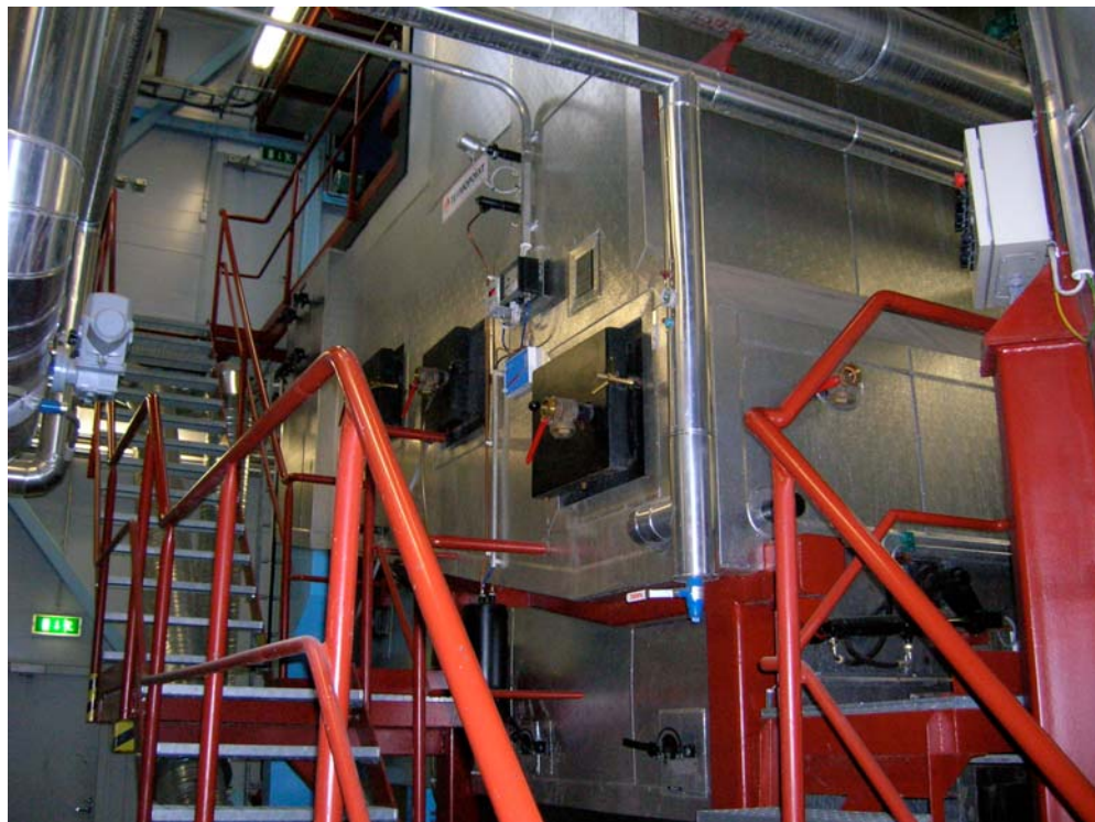
Kuva 12: Perniön arinakattila, kuvassa näkyy näkölasit 4 kpl.
